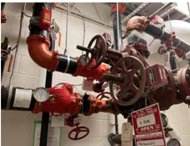
23 - FIRE SPRINKLER RISERS
